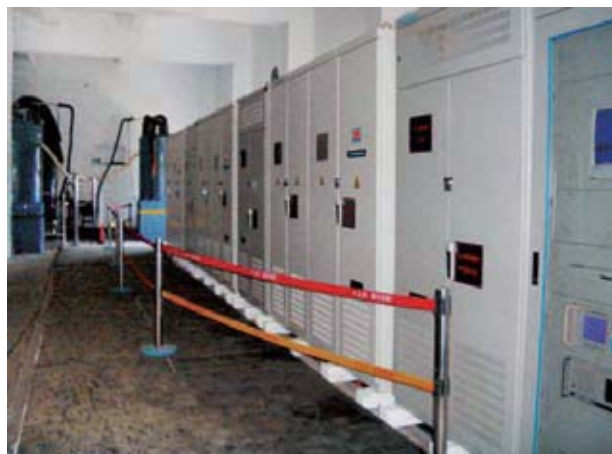
图8 10.5kV/1.5kA三相高温超导限流器
