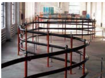
图7 75m/10.5kV/1.5kA三相交流高温超导电缆
