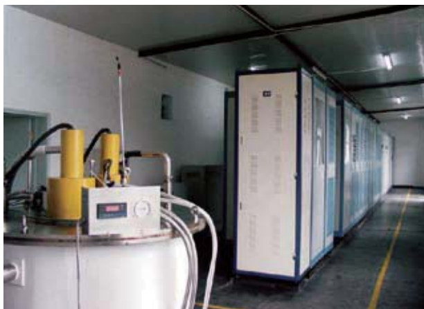
图9 1MJ/0.5MVA高温超导储能系统
