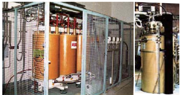
(a)瑞士ABB公司研制的630kVA超导变压器 (b)日本九州大学研制的1MVA超导变压器
