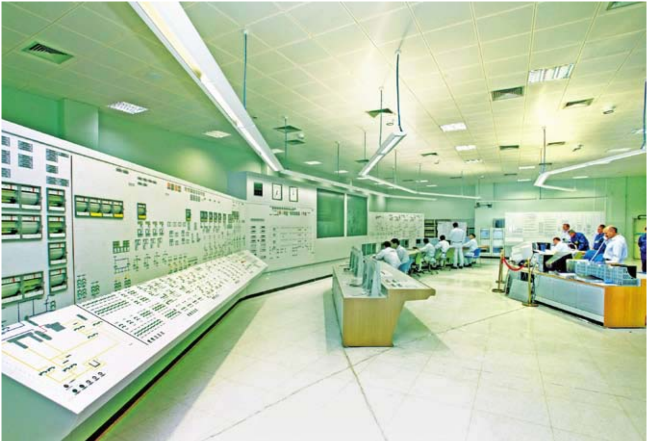
田湾核电站全数字化仪控系统主控室
