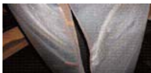
图3 主蒸汽管道爆裂
