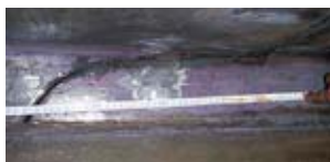
图4 大板梁发生断裂
