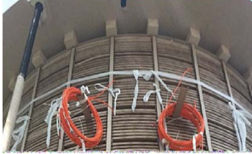
山东电力 1000KV油浸式电抗器应用
