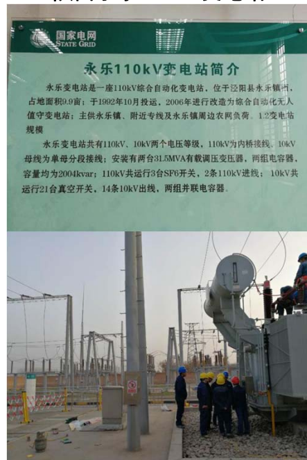
国家电网 陕西永乐110KV变电站
