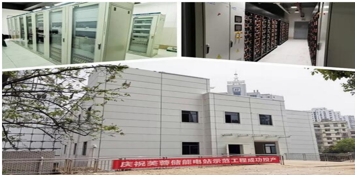
湖南长沙芙蓉储能站
