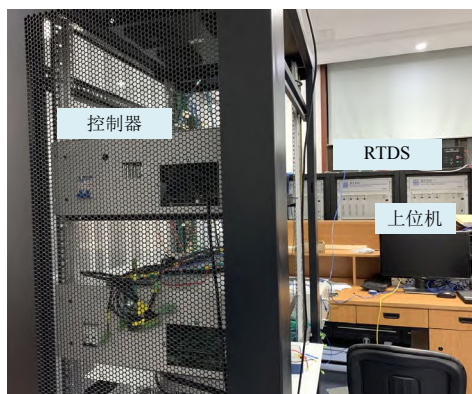
图9 基于RTDS的硬件在环测试系统
